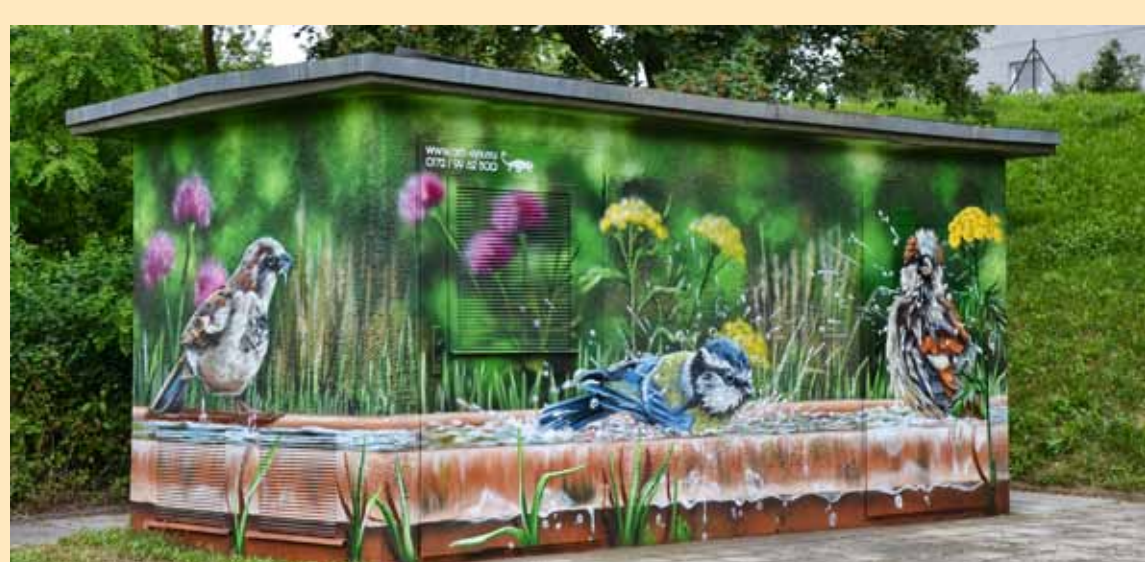
Neu gestaltete Trafostation
