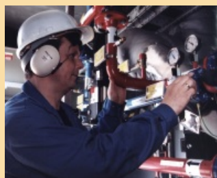
Inbetriebnahme des BHKW
