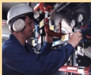
Inbetriebnahme des BHKW
