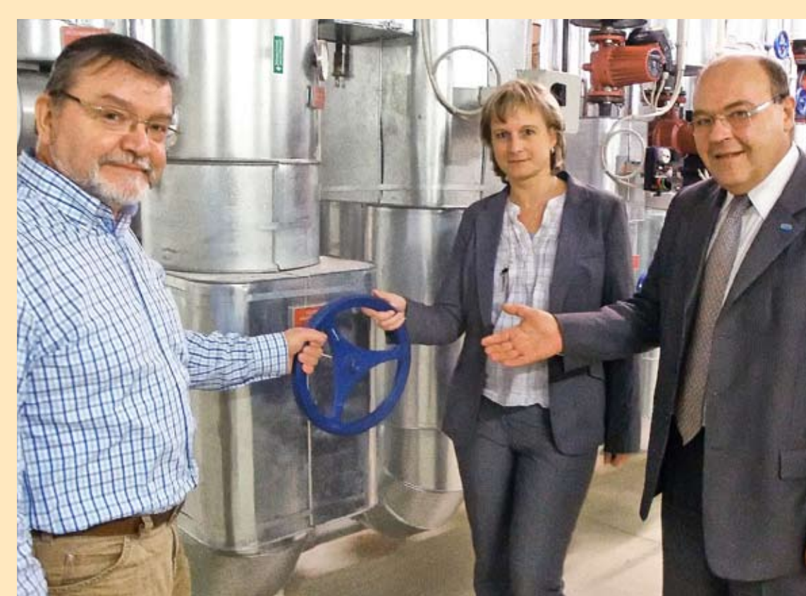
Start der DRV ins Fernwärmezeitalter
