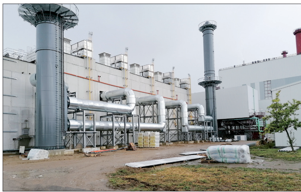
Die Kaminanlage mit ihren Abgasleitungen.
